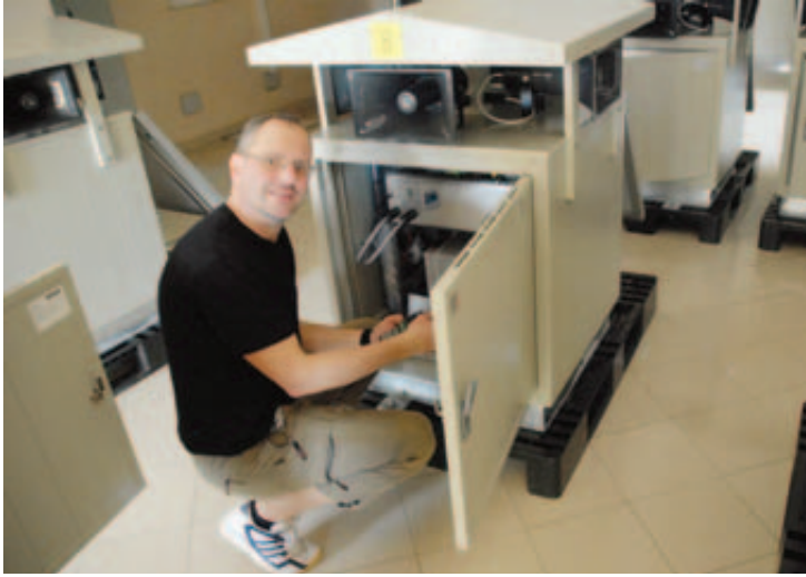
A l'aéroport de Cotonou, Marco Zobot, technicien de Planchamp Telecom, contrôle les générateurs avant leur implantation dans le terrain. DR
